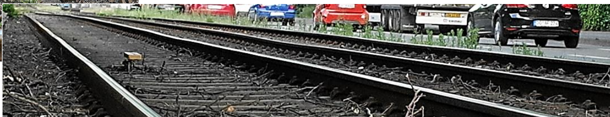
Schienen-Verschleiß und unebene Gleislage
